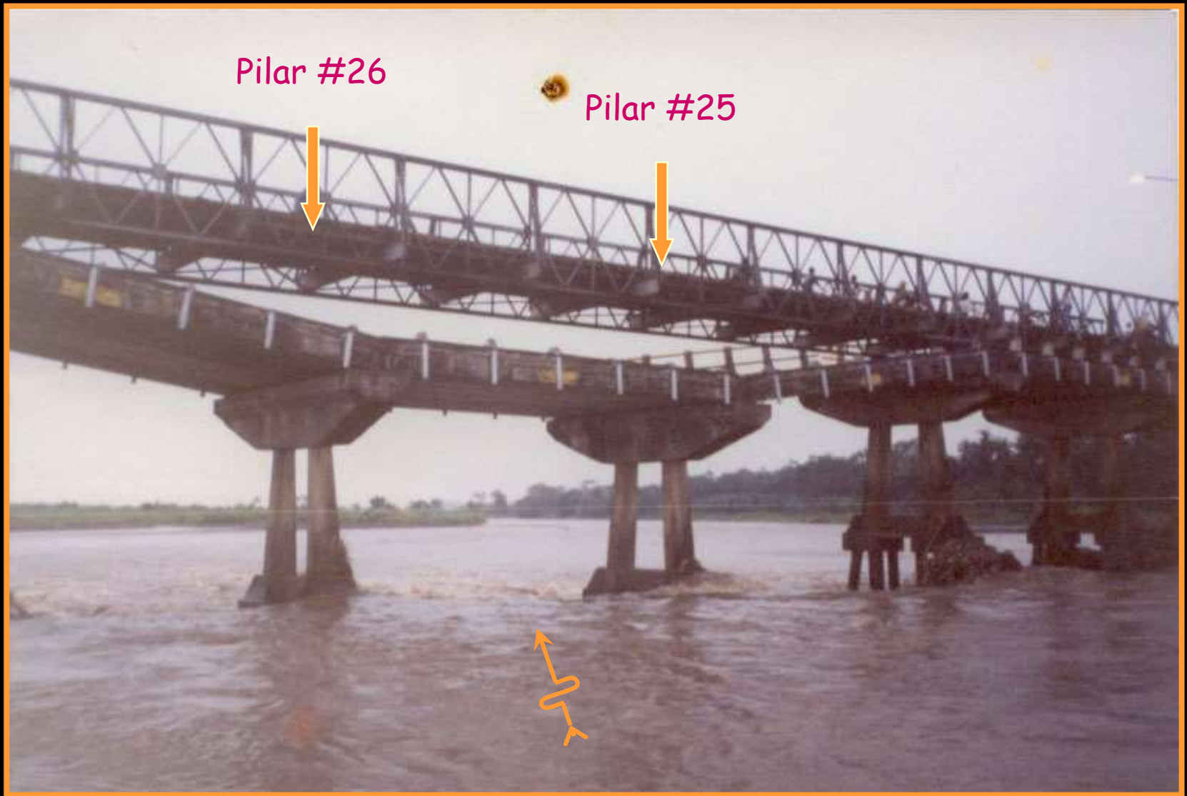
Kegagalan pilar #25 dan #26.
