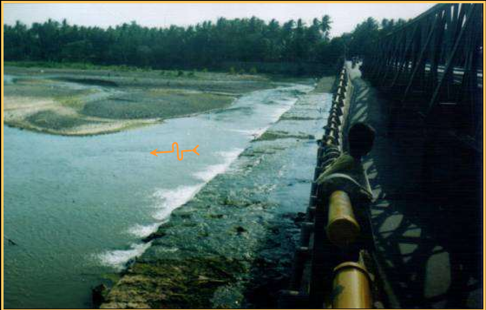
Lantai hilir dengan konstruksi bronjong pasca kegagalan pilar.
