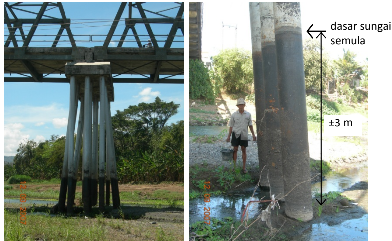
Gambar 3: Pilar Jembatan Kretek tersingkap lebih kurang 3 m akibat degradasi dasar sungai yang terjadi segera setelah kerusakan groundsill pada 25 Juni 2007.
