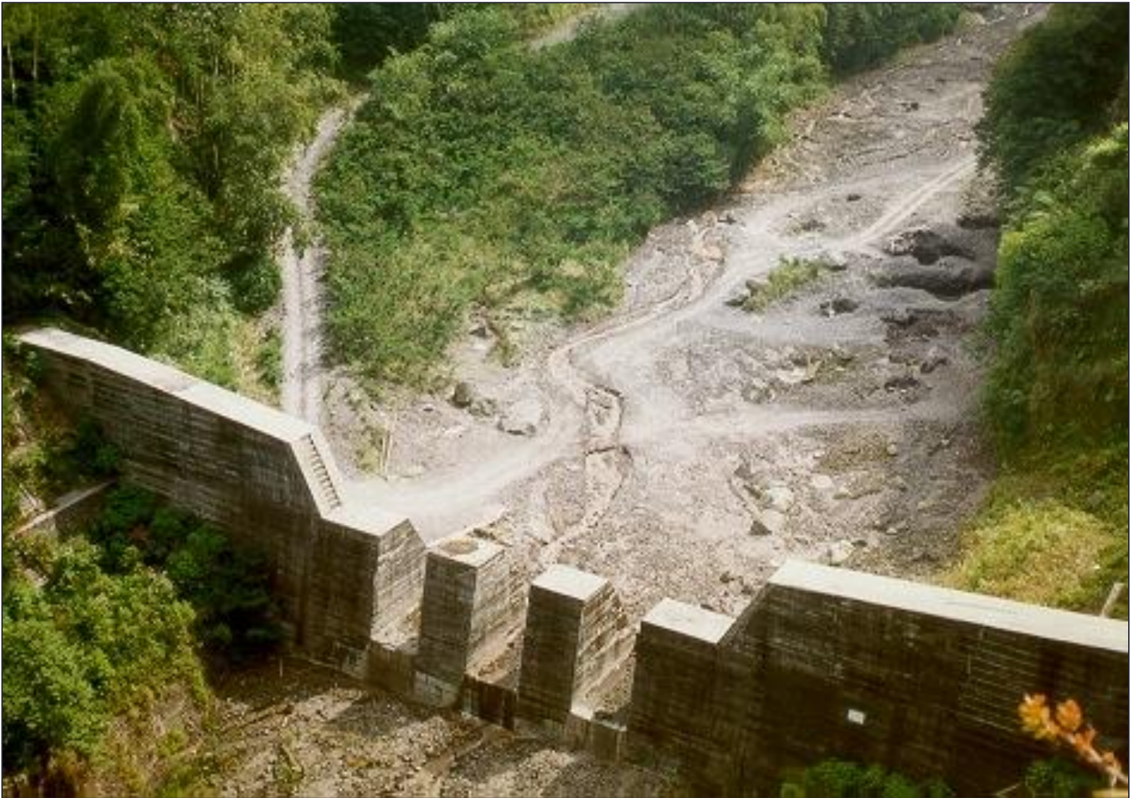
Check-dam di K. Boyong BO-D7: celah (slit) memungkinkan sedimen mengalir ke hilir pada aliran normal.
