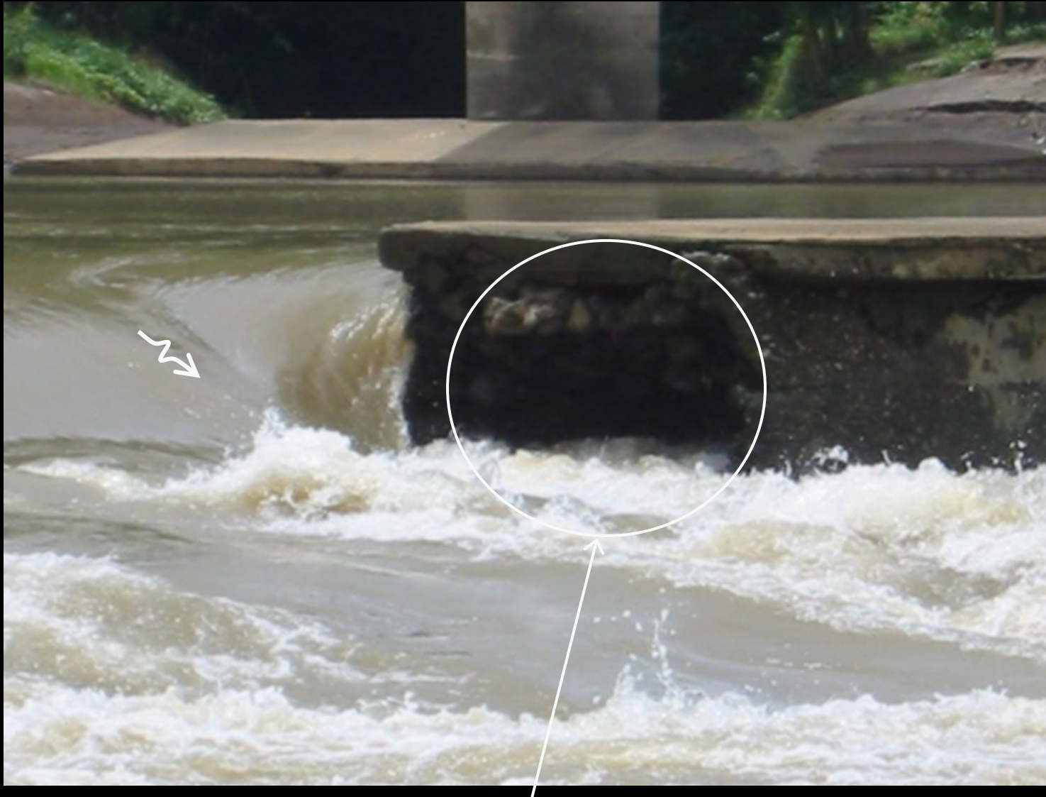
Penampang patahan groundsill yang keropos.
