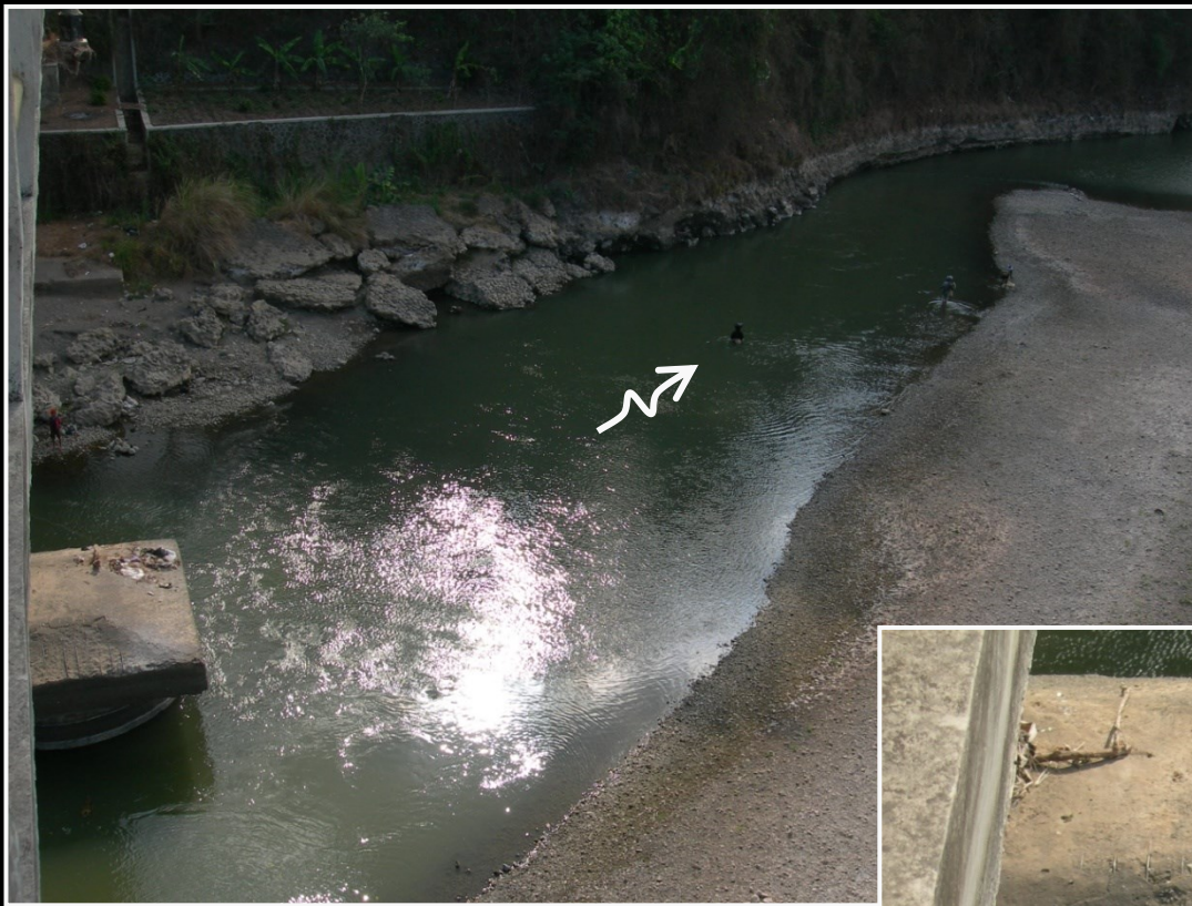
Jejak degradasi dasar sungai di sekitar jembatan (September 2006).
