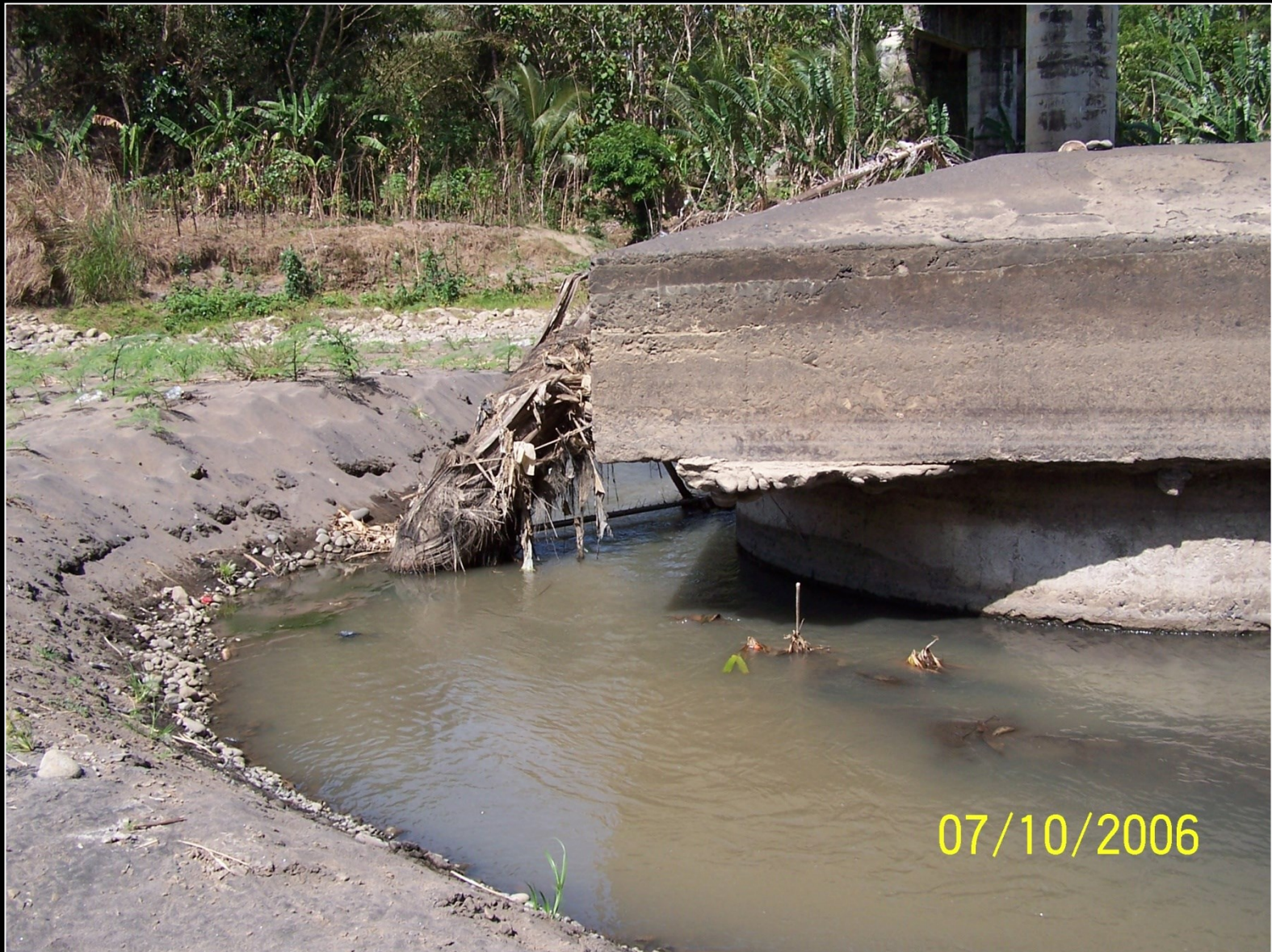
Degradasi dasar sungai + Gerusan lokal di sekitar pilar
