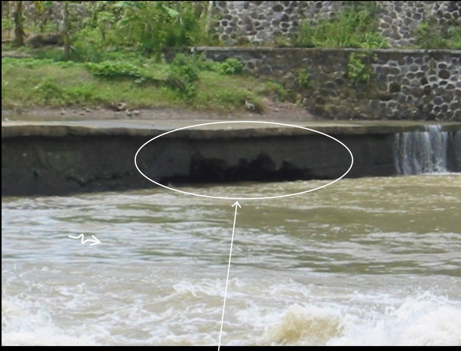
Groundsill bagian kiri yang keropos.
