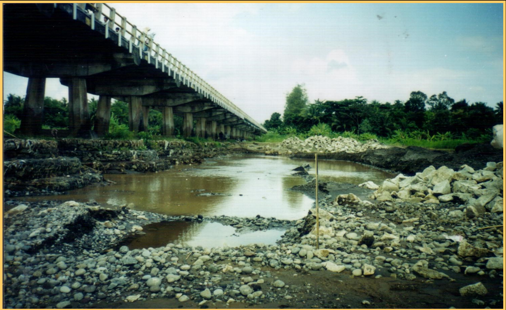
Galian untuk lantai hilir dari konstruksi bronjong (sebelum kegagalan pilar).
