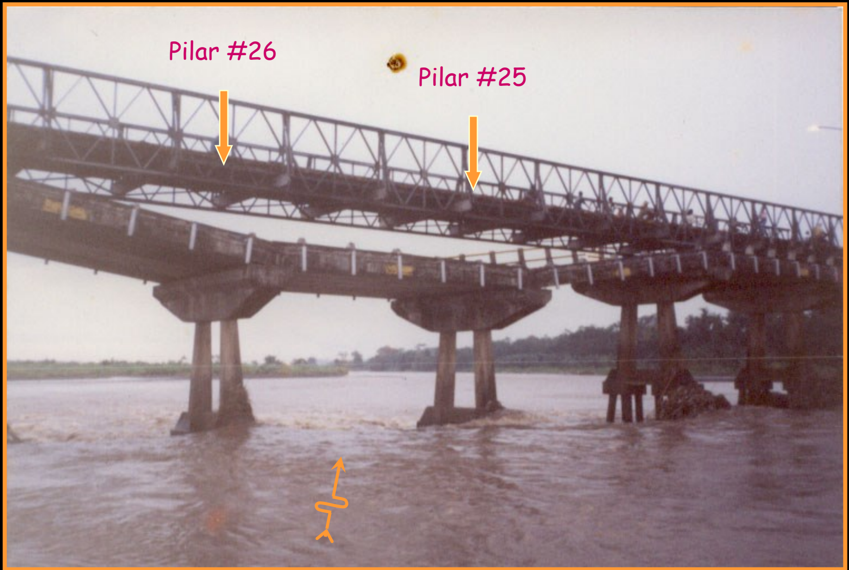
Kegagalan pilar #25 dan #26.
