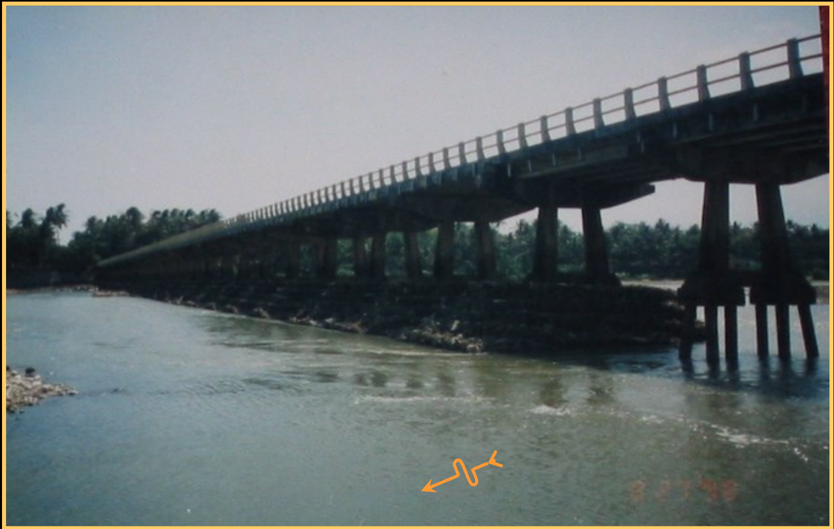
Pelindungan pilar dengan selimut bronjong yang tidak tuntas.
